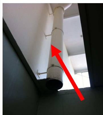
Composant : Conduit de fluide (air) 9 (a) Gaine circulaire Local 6337
