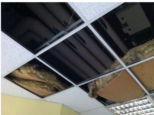
Composant : Calorifugeage 1 (N) Laine de verre Réseau vapeur 3 bar
